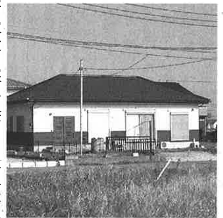
植栽や外構が未整備のように見られてしまう平屋建ての新築住宅
